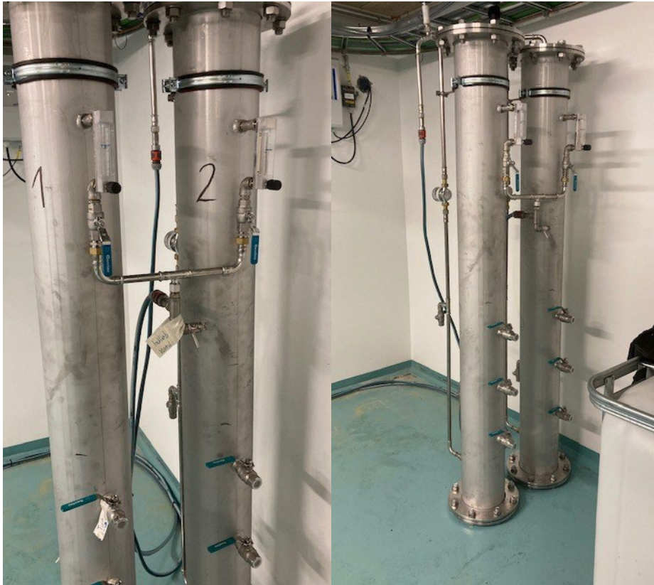
Figur 3 Semiteknisk opstilling på Frederiksberg Forsyning. Begge filtre er tryksatte og fyldt op med Filtrasorb-400 som filtermateriale.
